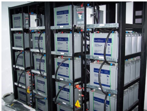
Banco de Baterías
